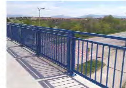
Obr. 7 Zábradlie so zábranou proti padaniu snehu
